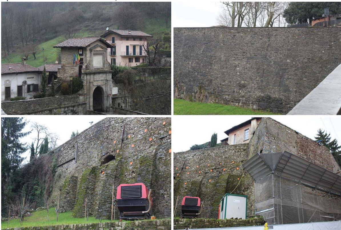
La sede dell'associazione e le mura di Venezia (nelle ultime due foto ci sono le crepe per le quali il Comune ha reagito immediatamente)
