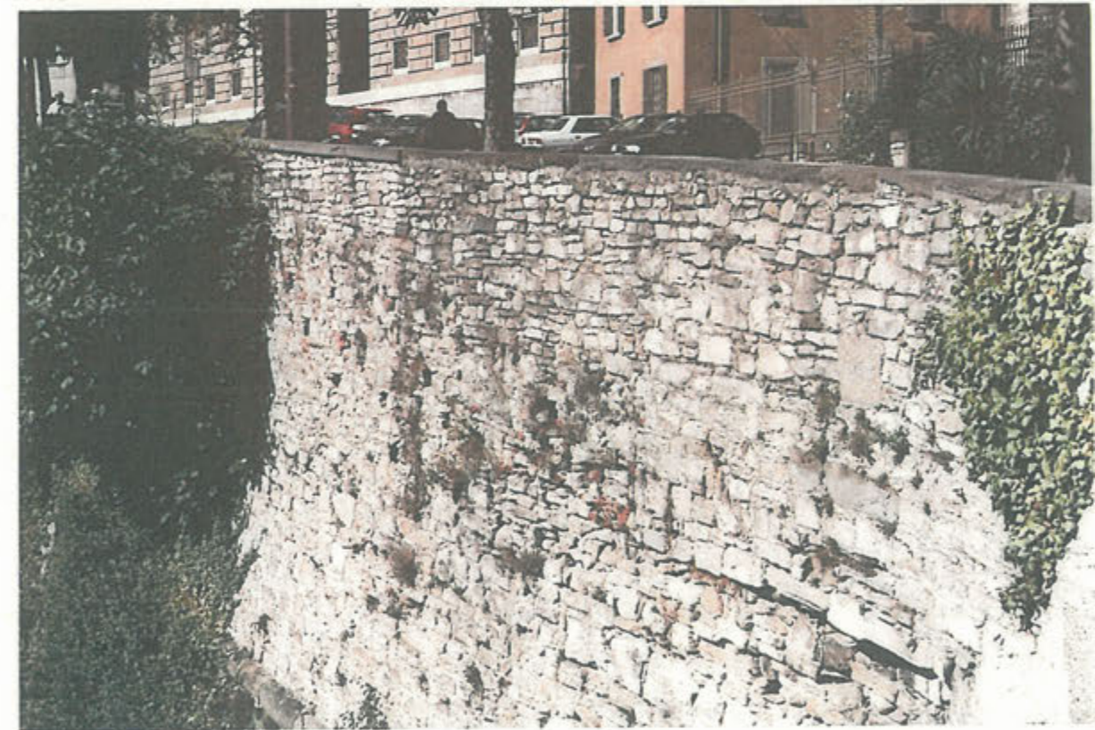
PARTICOLARE DEGRADO DELLE MALTE NELLA FINALE DEL TRATTO "2"
