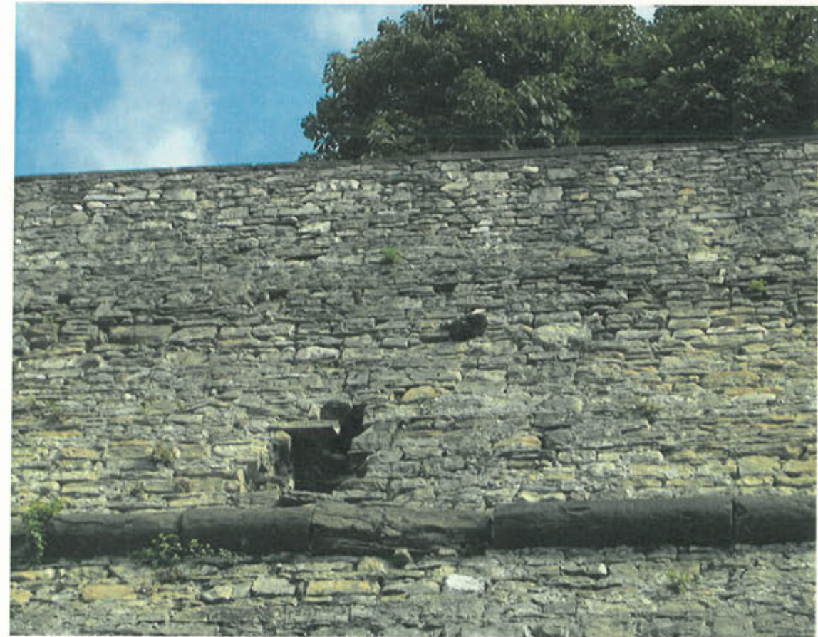
PARTICOLARE A SINISTRA DELLA FUNICOLARE DELLE LACUNE RICONTRATE DOPO LA PULIZIA DA PARTE DEGLI ALPINI
