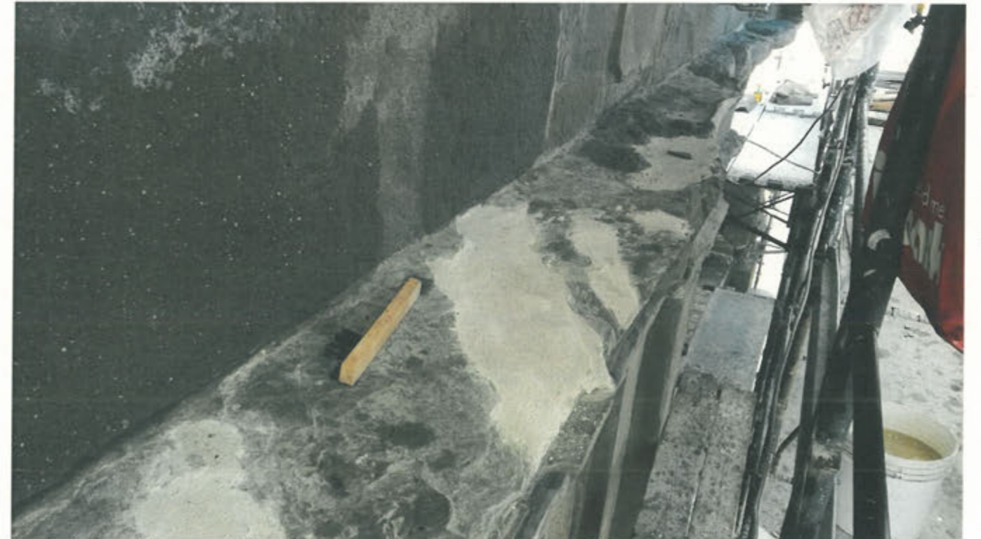
La sigillatura delle superfici orizzontali per impedire il ristagno dell'acqua meteorica
