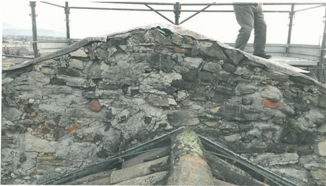
La superfici del timpano prima dei lavori, era una delle principali cause di infiltrazione
