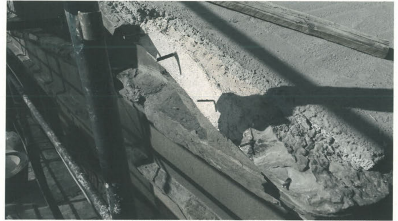
La ricostruzione di una delle parti mancanti del timpano mediante l'inserimento di perni in acciaio inox
