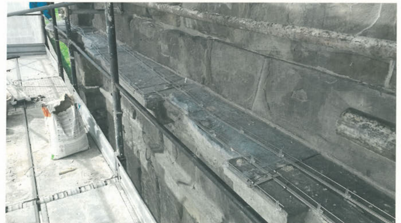
L'impianto antipiccioni sulla fascia marcapiano principale, si evidenziano i giunti tra le lastre di piombo per ovviare agli inconvenienti provocati dalla dilatazione del materiale
