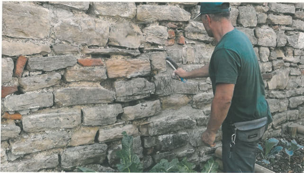
MURATURA – In base al tempo di asciugatura della malta, poche ore nel caso di giornate asciutte, uno due giorni in caso di giornate umide, si procedeva alla spazzolatura della malta per portare in risalto gli inerti, ed al lavaggio con spruzzini delle pietre per evitare il formarsi di aloni
