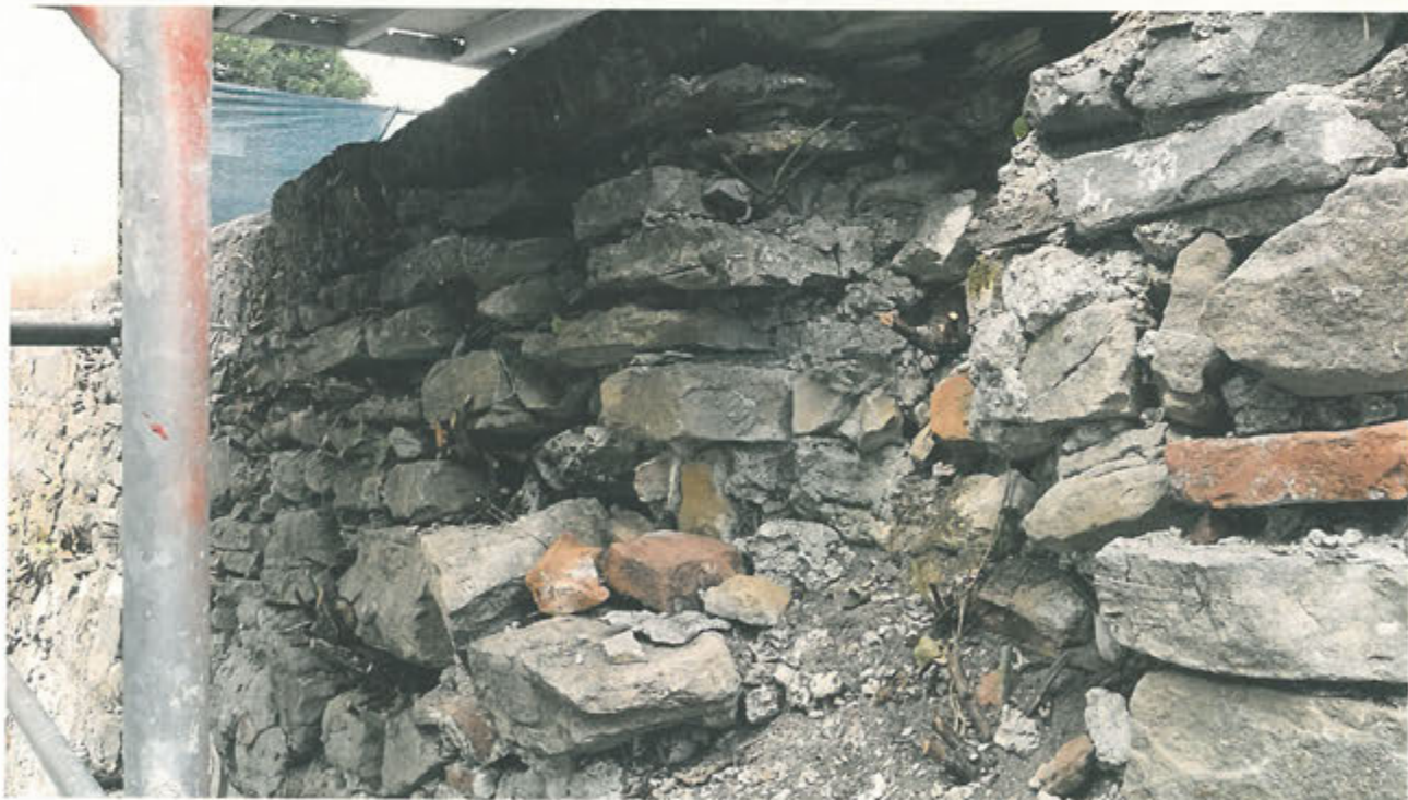
28 – rovi dopo con dissesto localizzato
