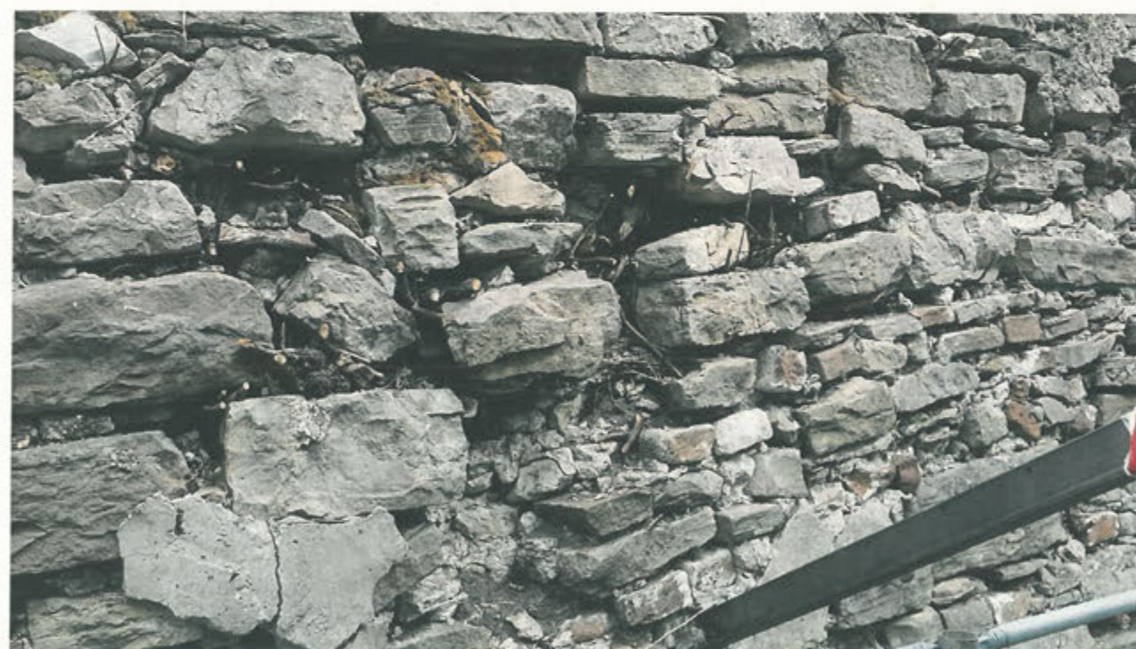
28 – rovi dopo con dissesto localizzato
