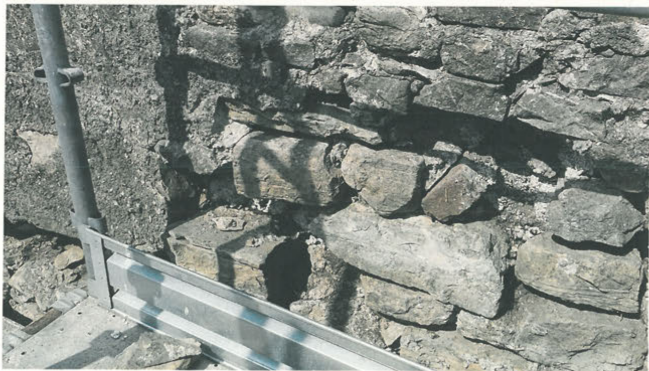
28 – rovi dopo con dissesto localizzato dettaglio
