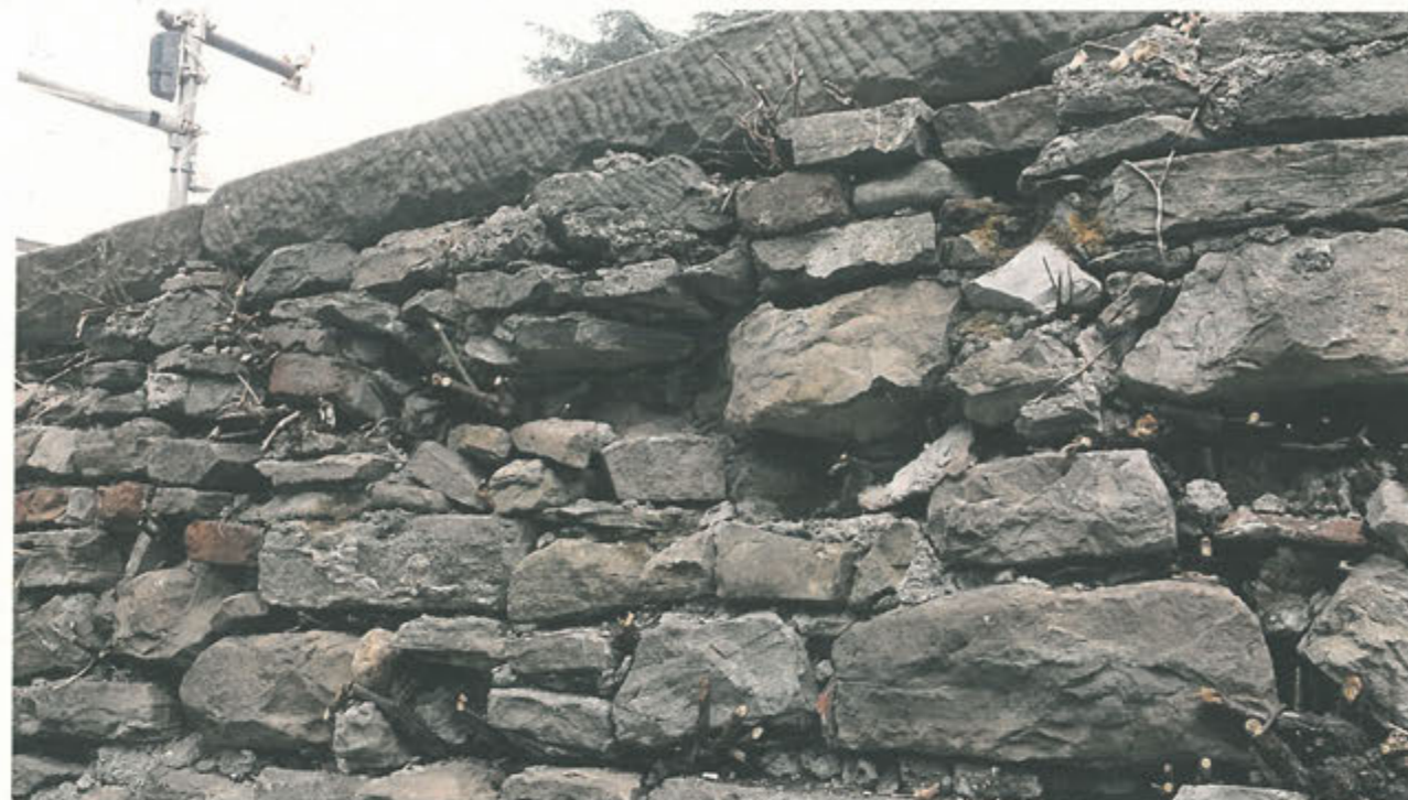
28 – rovi dopo con dissesto localizzato
