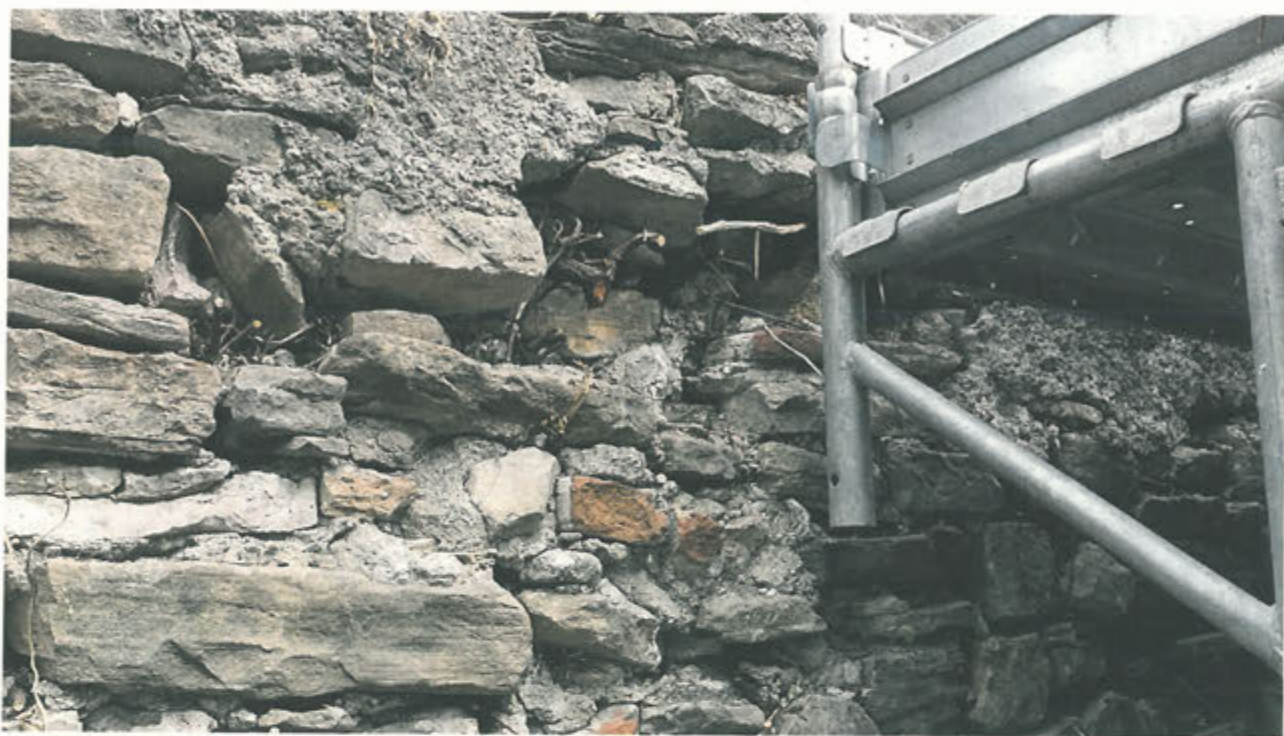
28 – rovi dopo con dissesto localizzato
