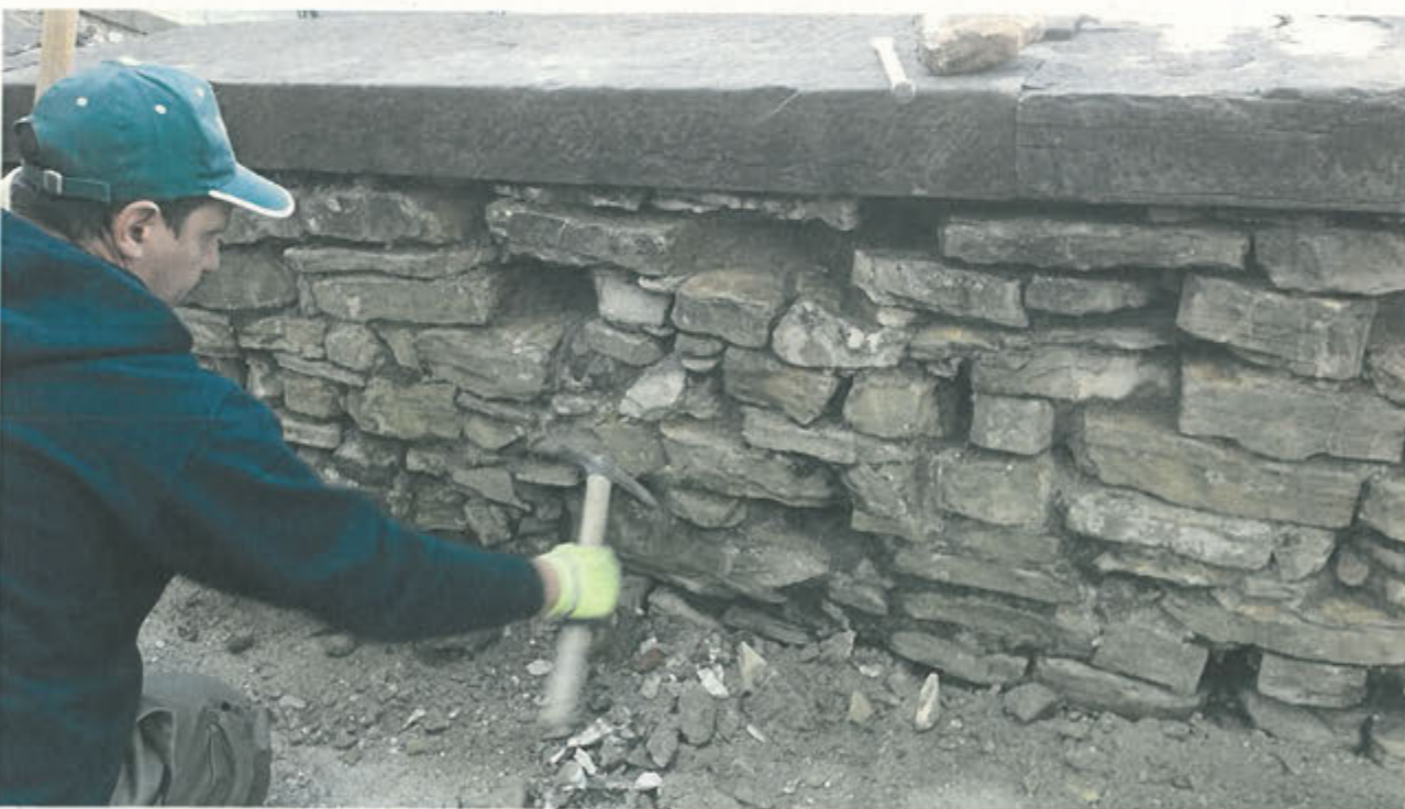
LATO INTERNO PARAPETTO - Rimozione malte cementizie, distaccate e/o in fase di distacco
