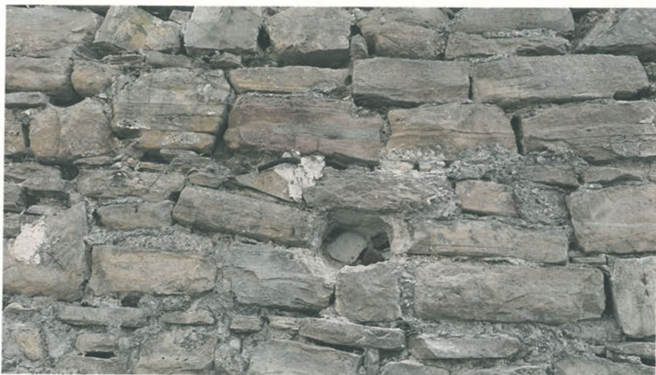
11- mancanze per rimozione elemento metallico
