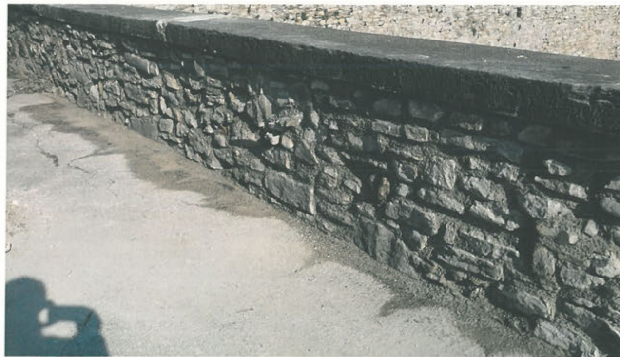
LATO INTERNO PARAPETTO – ricostruzione con cuci-scuci e risarcitura delle malte tratto C7-C8
