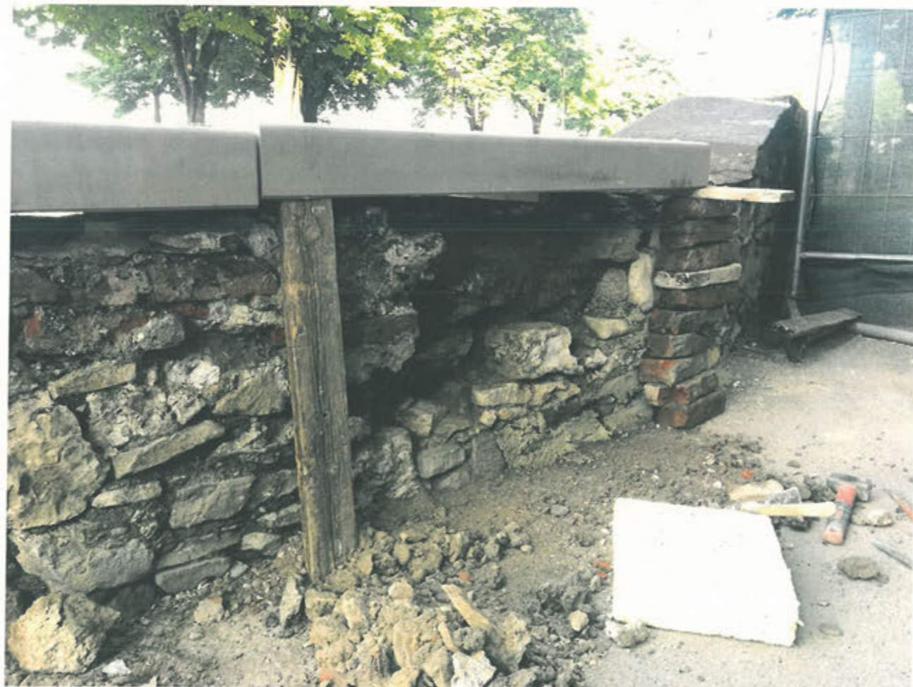
LATO INTERNO PARAPETTO – ricostruzione con cuci-scuci e risarcitura delle malte tratto C10-C11 con sostituzione copertine
