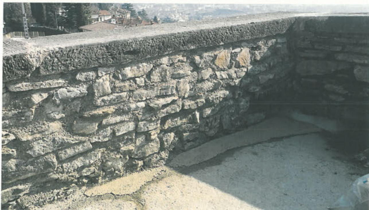
LATO INTERNO PARAPETTO – ricostruzione con cuci-scuci e risarcitura delle malte tratto C7-C8
