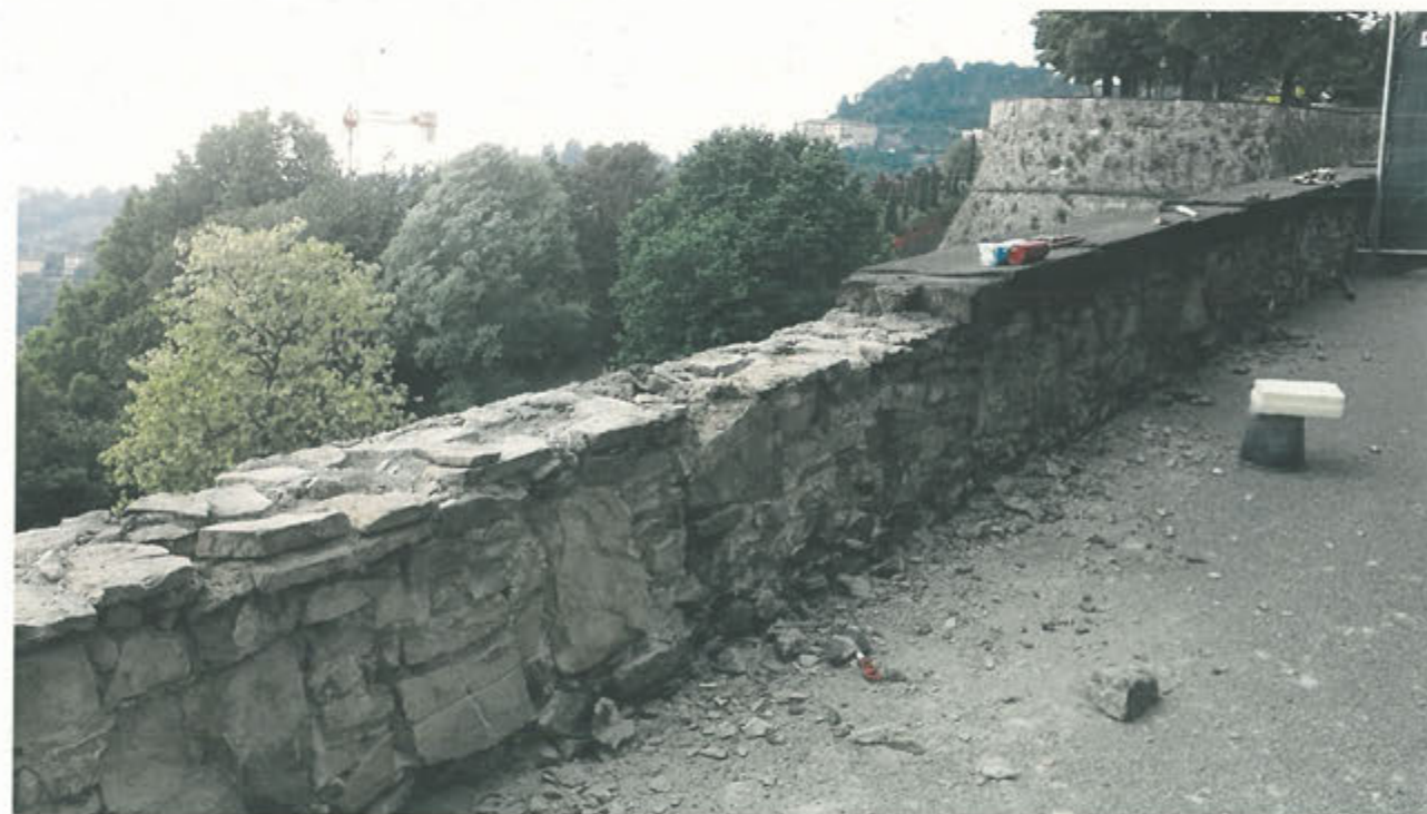
LATO INTERNO PARAPETTO – ricostruzione con cuci-scuci e risarcitura delle malte tratto C10-C11 con sostituzione copertina
