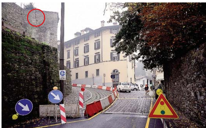
Il tratto di strada con il senso unico alternato. In alto a sinistra, nel cerchio, la crepa nel muro FOTO BEDOLIS
